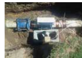
Instalación en la tubería de Club de Golf las Misiones C.C. de calmat® PLUS.
